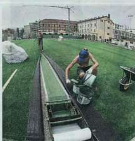
Al lavoro L'impresa sta stendendo i telami per consegnare il campo a giorni
